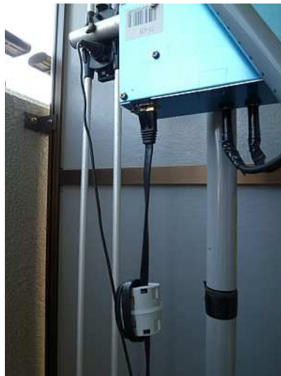
室外 BOX 部分の写真
